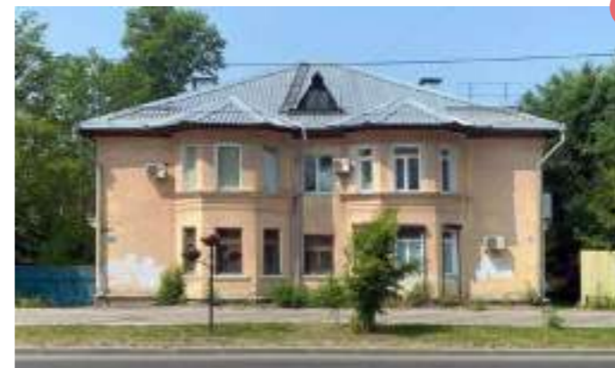
Использование краски НЕСООТВЕТСТВУЮЩЕГО ЦВЕТА при закрашивании граффити привело к появлению заметных пятен
