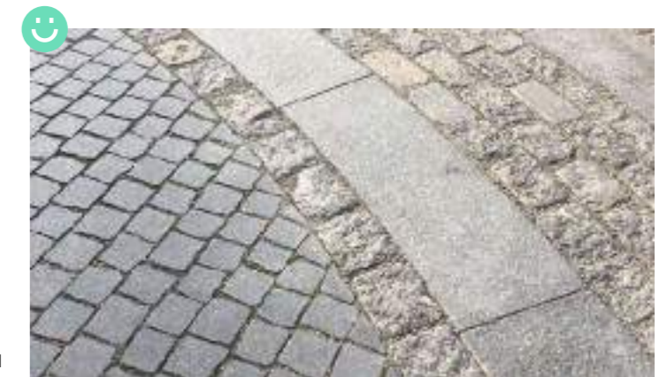
Мелкая плитка аккуратно обрезана на СТЫКЕ с более крупной плиткой
