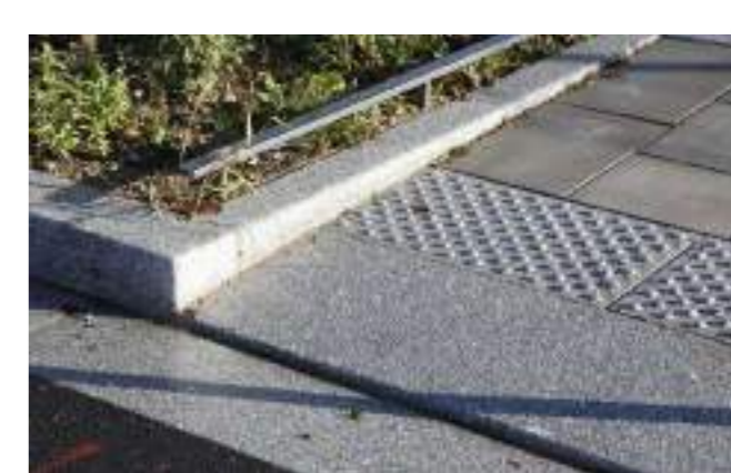
Бордюрный съезд обеспечивает МГН доступность с тротуара на проезжую часть. Съезд оснащен тротуарной плитой
