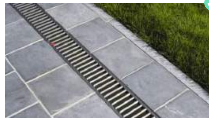
Организована СИСТЕМА ВОДООТВЕДЕНИЯ, элементы которой гармонично сочетаются с покрытием
