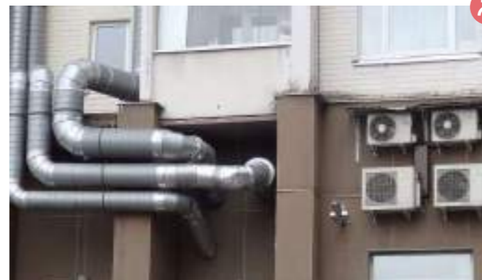
ВЕНТИЛЯЦИОННЫЕ ТРУБЫ нарушают архитектурный облик фасада из-за своего хаотичного расположения
