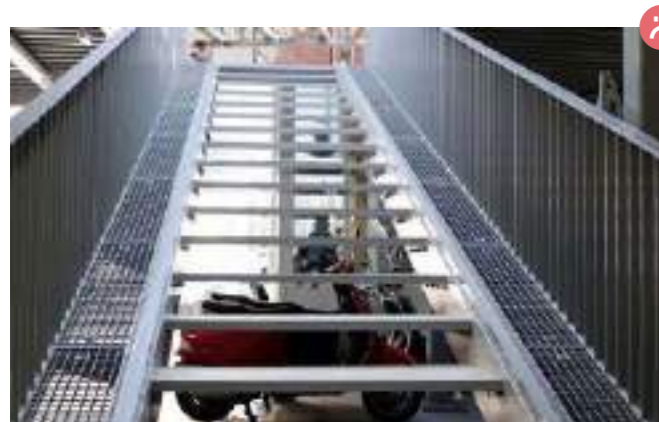
Ступени лестницы выполнены без подступенков, а также отсутствует пандус
