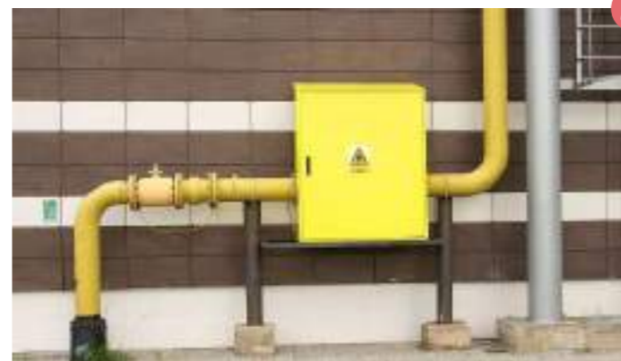
ЩИТОК выполнен не в колористической гамме, гармонирующей с общим оформлением здания
