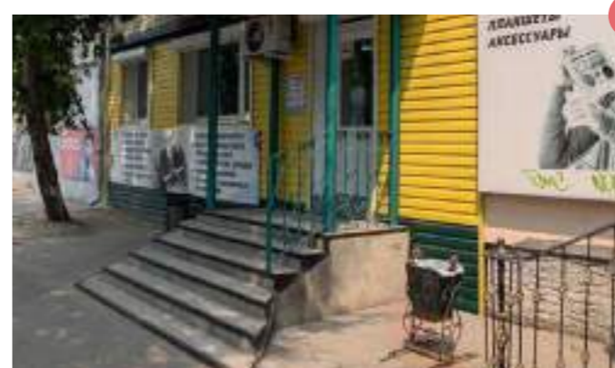
Использование недолговечных отделочных МАТЕРИАЛОВ цоколя не соответствует требованиям дизайн-кода
