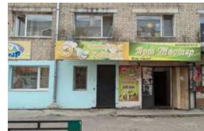
НЕПРОЗРАЧНЫЕ ВХОДНЫЕ ГРУППЫ зданий, плохое состояние существующих дверных и оконных проемов.
