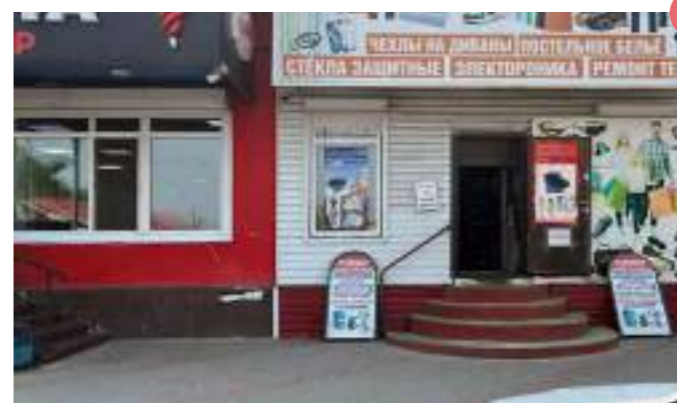
Цоколь НЕ ИМЕЕТ ЕДИНОГО РЕШЕНИЯ, выполнен из разных материалов, что нарушает целостность восприятия
