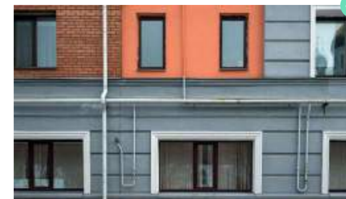
ГАЗОВЫЕ ТРУБЫ окрашены в цвет здания, тем самым бережно интегрируясь в плоскость фасада
