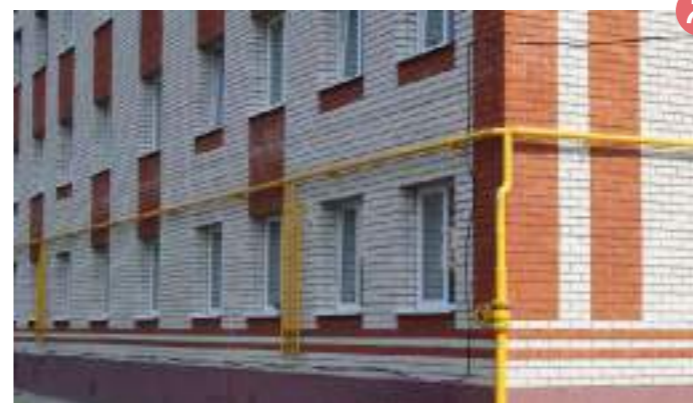
ГАЗОВЫЕ ТРУБЫ окрашены в яркий желтый цвет, что портит внешний облик здания
