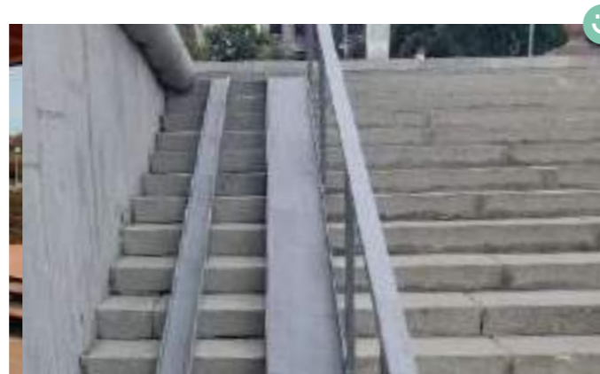
Ступени лестницы оснащены подступенками, а сама лестница оборудована пандусом, в том числе швеллером для велосипедов
