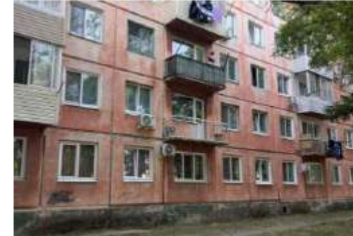
ОТСУТСТВИЕ ЕДИНОГО РЕГЛАМЕНТА по работе с элементами фасадов здания (балконами, лоджиями) нарушает целостность фасада
