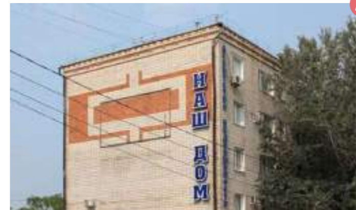
Кирпичная МОЗАИКА перекрыта вывеской и остатками рекламных конструкций
