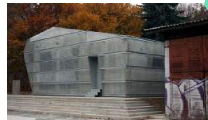
Трансформаторная подстанция, г. Целье
